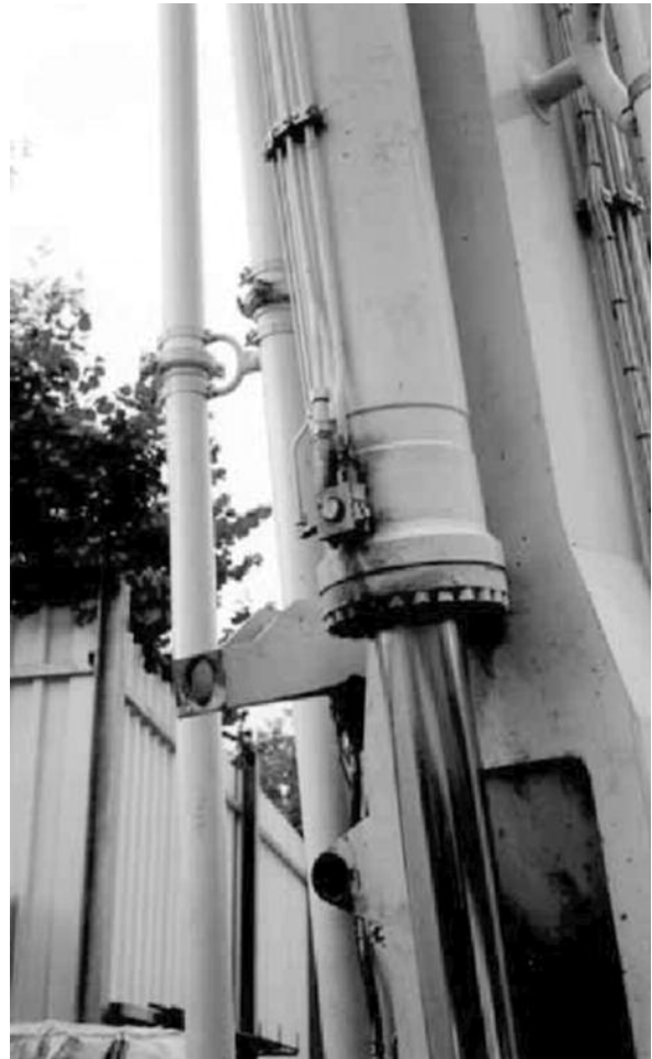
Cilindros hidráulicos con válvula de retención.
